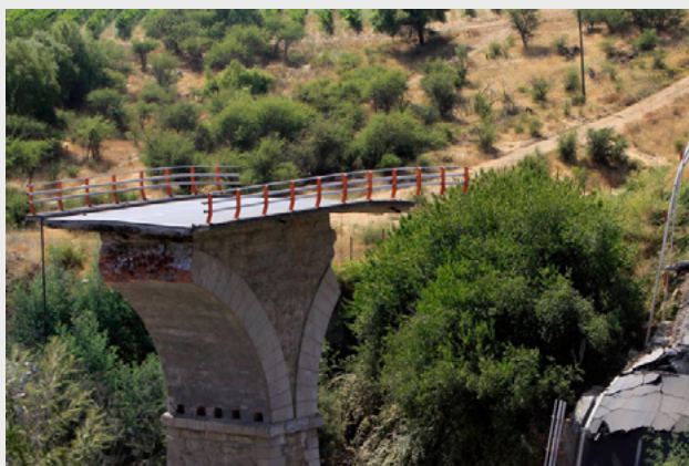
Figura 2: Puente río Claro luego del terremoto del 2010.
