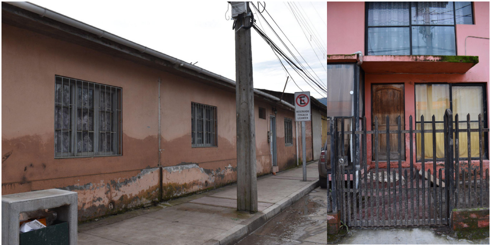
Figura 14. Afectación de viviendas en Licantén.
