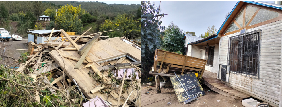
Figura 20. Afectación de viviendas en Piedra del Lobo.
