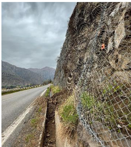
Figura 20. Desprendimiento de rocas km 50.
