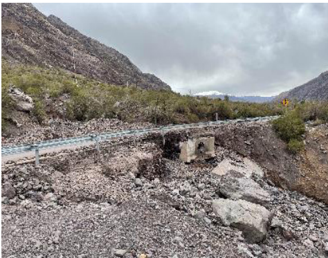
a. Alcantarilla afectada en km 68.7
