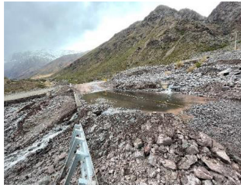
b. Obra de arte afectada en km 71
