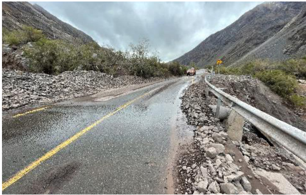
Figura 16. Tramo afectado por flujo de detritos en sector el volcán.
